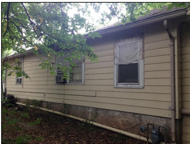
A9.) Failing Windows
