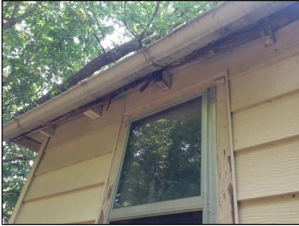
A11.) Rotten Fascia
