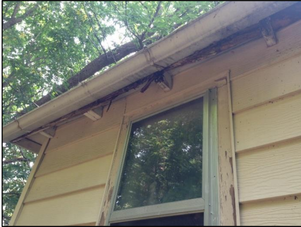
A11.) Rotten Fascia
