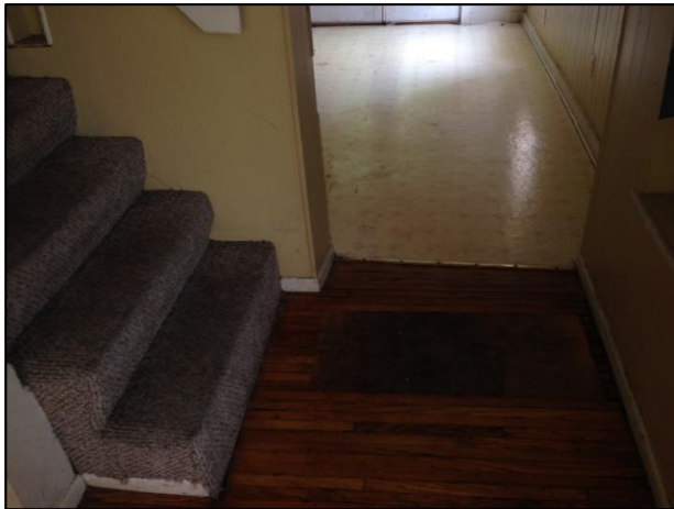
A19.) Sagging flooring
